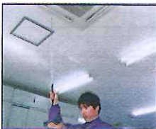
エアコンの噴出し口
