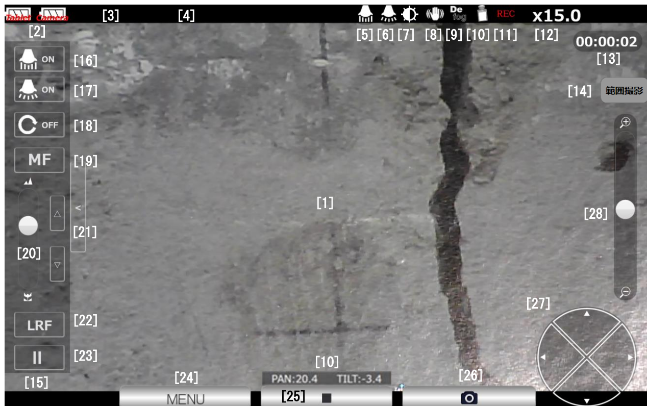
図 4-11 点検カメラコントロール メイン画面
