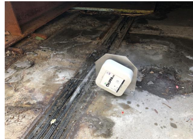
橋梁の遊間部監視
