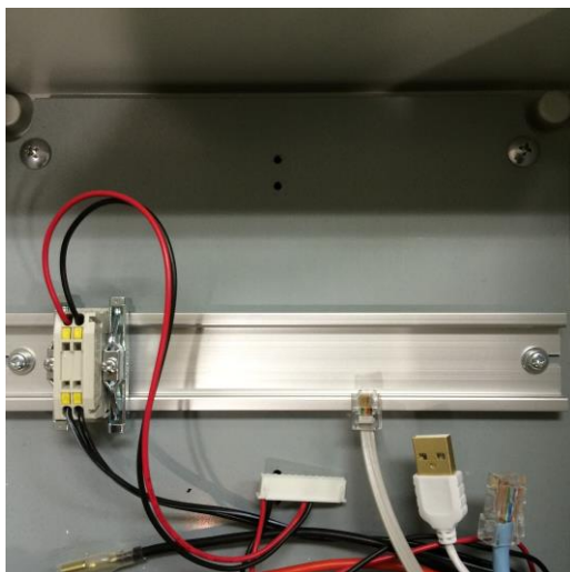
【写真 5-1 本体設置場所】
