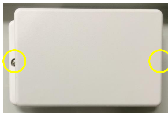
【写真 5-4 LTE ボックス設置後】
