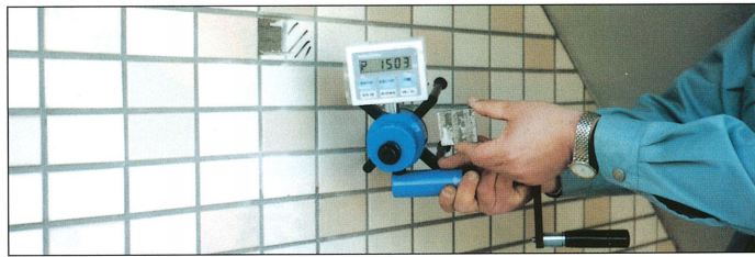
(外装タイル接着強度測定)
