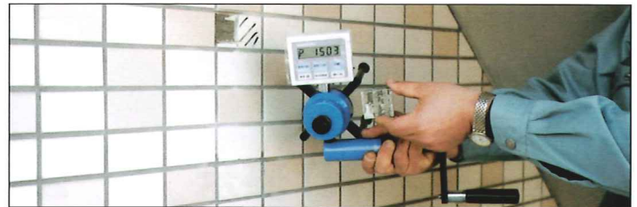
(外装タイル接着強度測定)
