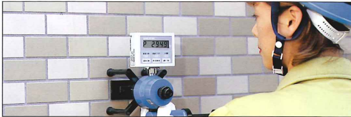
(外装タイル接着強度測定)
