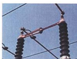
電源遮断機の実画像
