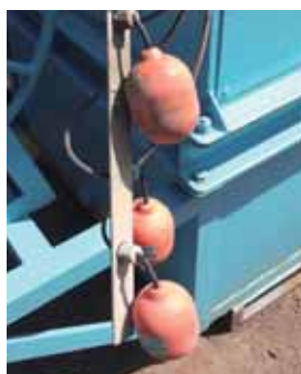
フロートスイッチによる給水制御 (渇水停止機能)
