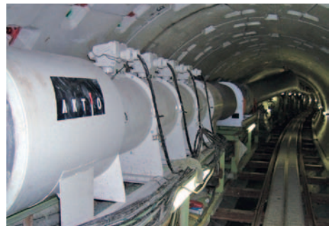
・坑内設置例
